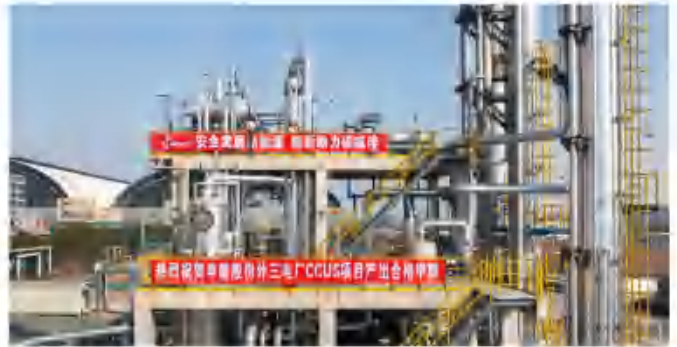
上海外三电厂二氧化碳捕集制甲醇绿色化工示范项目 万吨级电厂烟气二氧化碳捕集制甲醇项目
